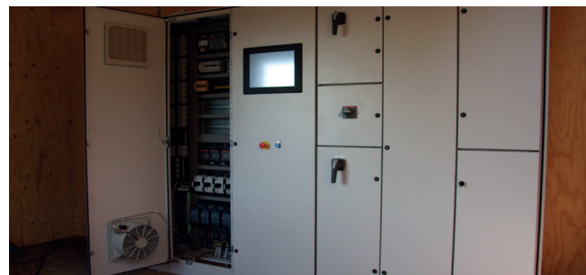
PLC/PC lösningar till anläggningar i alla storlekar där det ingår flera silor och transportörer med behov av styrning och överblick.
